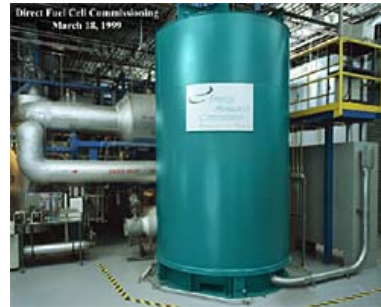
Centrale di 2,5 MW con MCFC
